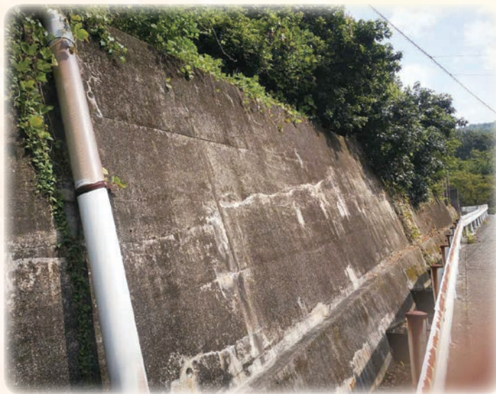
これでいいのか 南小擁壁コンクリート
