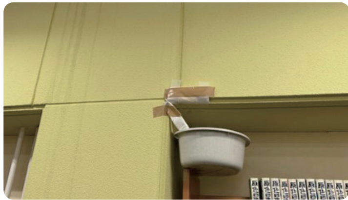
雨漏り対策と雨漏りの跡
