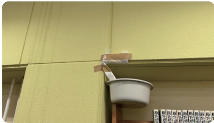
雨漏り対策と雨漏りの跡
