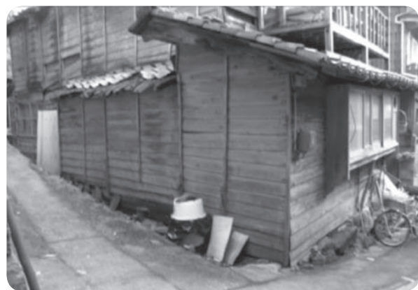
環境の悪化と危険がいっぱいの空き家
