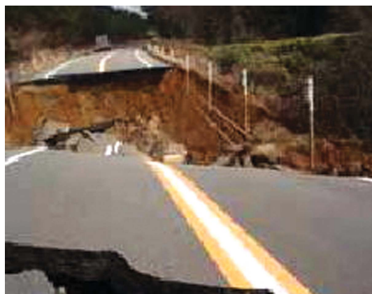
能登半島での被災状況
