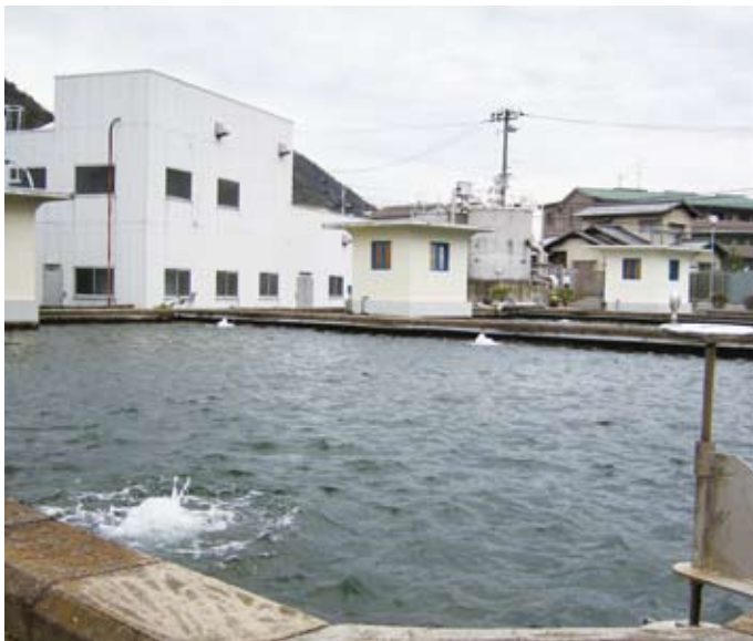
蟹原浄水場のろ過池
