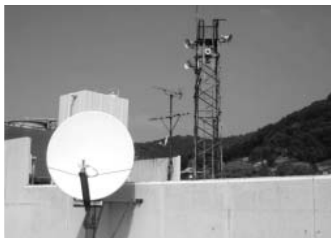
役場庁舎の屋上にある衛星通信用パラボラアンテナです
