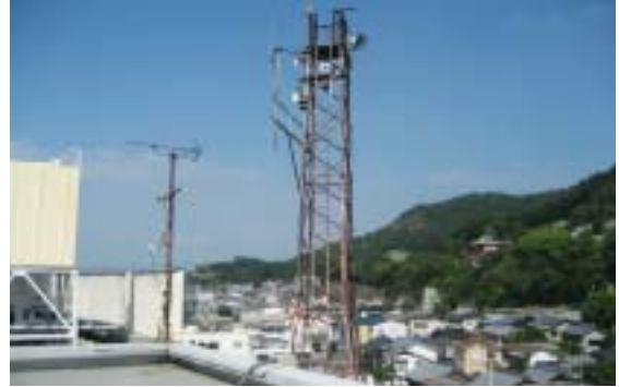
更新が待たれる本町の防災行政無線送信設備
