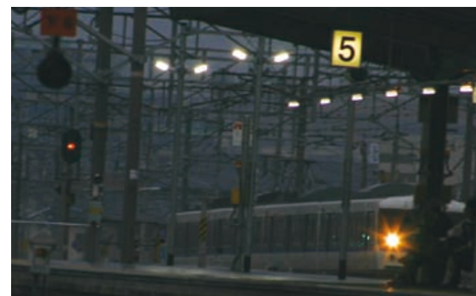
海田市駅呉線ホームのLED照明
