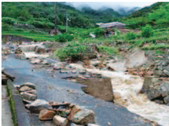
損壊した町道6号と西ノ谷川
