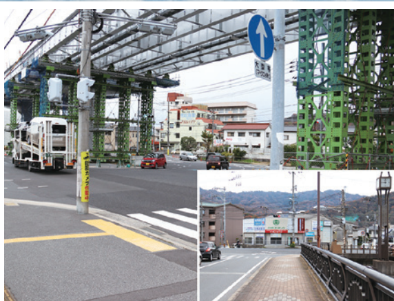
危険な西浜・日下橋交差点
