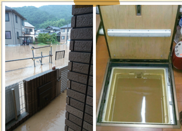
床下浸水の現状です(右側は床下収納庫)
