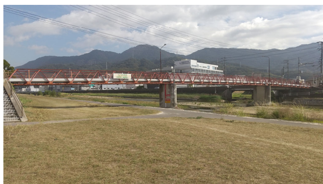
老朽化が進む石原橋
