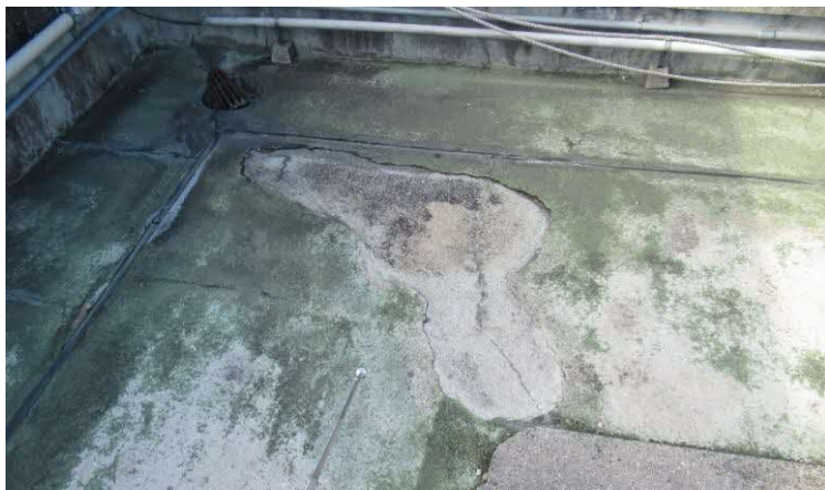
例) 屋上面の劣化
