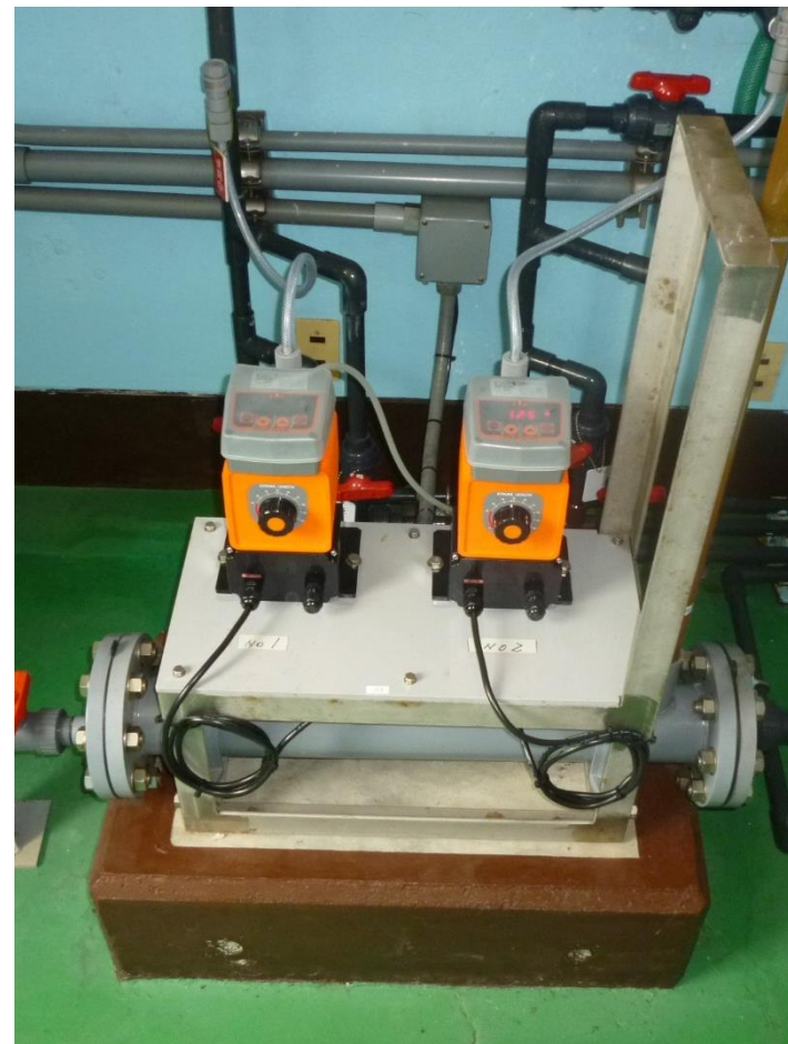
次亜塩素酸ナトリウム注入ポンプ
