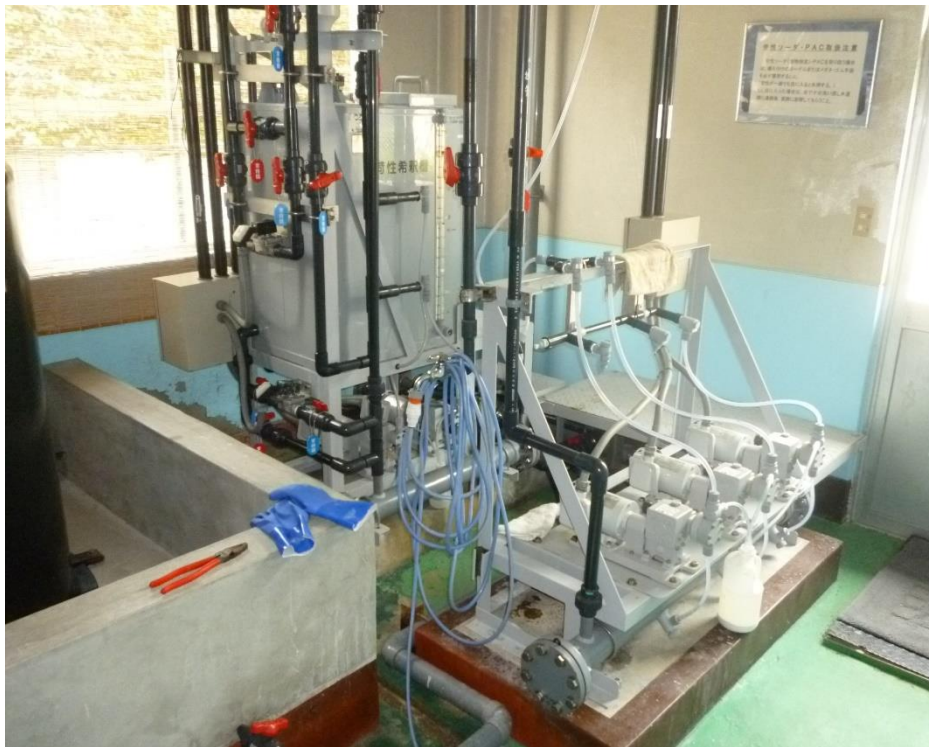
苛性ソーダ注入ポンプ PAC注入ポンプ
