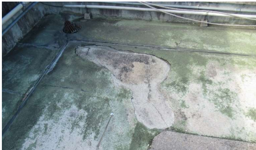
例) 屋上面の劣化
