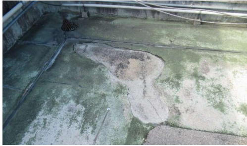
例) 屋上面の劣化
