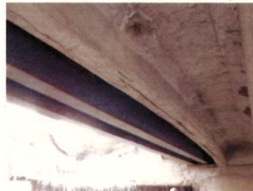
コンクリート主桁のひびわれ、うき・剥離・鉄筋露出
